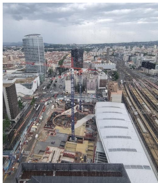
La nouvelle entrée de la gare de la Part-Dieu avec son toit blanc et à l'avant, le chantier de réaménagement de la place Béraudier. Photo Aline Duret
